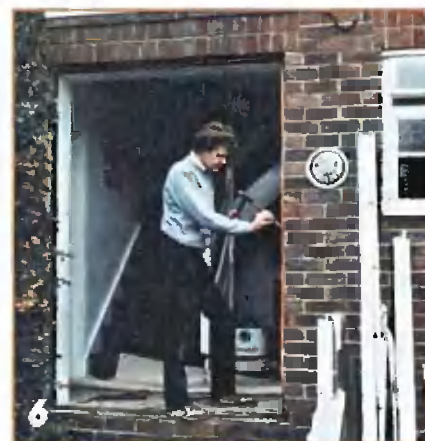
6 Коробка полностью удалена. Чтобы новая коробка встала в проем, его зачищают по периметру, удаляя остатки старого раствора.
